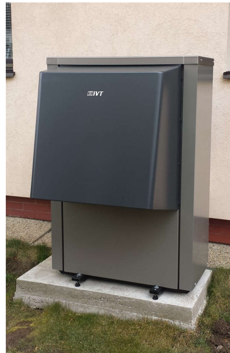
Dodatečně instalovaný protihlukový kryt
